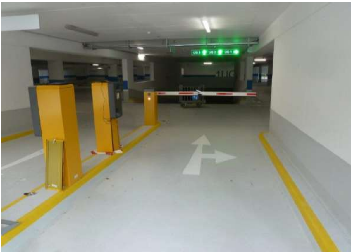
Foto 2: Schrankenanlage im Ein- und Ausfahrtsbereich der Hauptgarage
